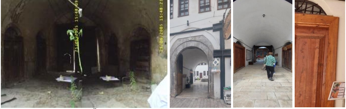
Şekil 13. Restorasyon Öncesi Yapının Giriş Eyvanında Bulunan Dört Adet Kapı (Kaplan, 2007) ve Şekil 14. Restorasyon Sonrası Giriş Eyvanında Bulunan Kapılar (Güneş, 2023)
